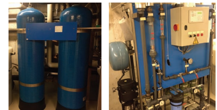
Wasserenthärtungsanlage und Osmosefilter
