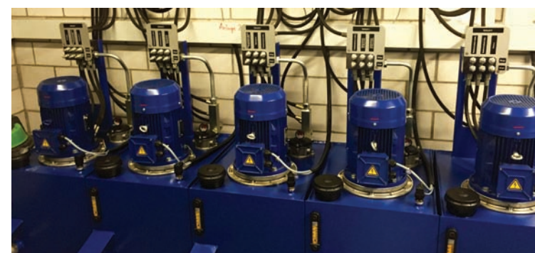
Fünf Hydraulikkompressoren pro Waschstrasse
