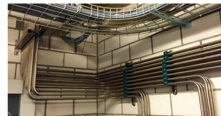
Ein paar hundert Meter Edelstahlleitungen
