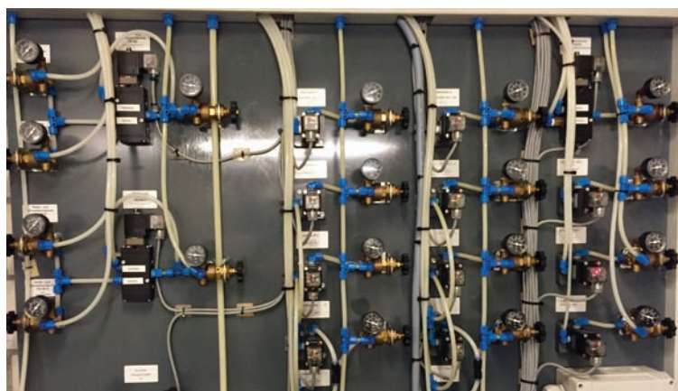
Das pneumatische Haupttableau für alle Aussteuerungen
