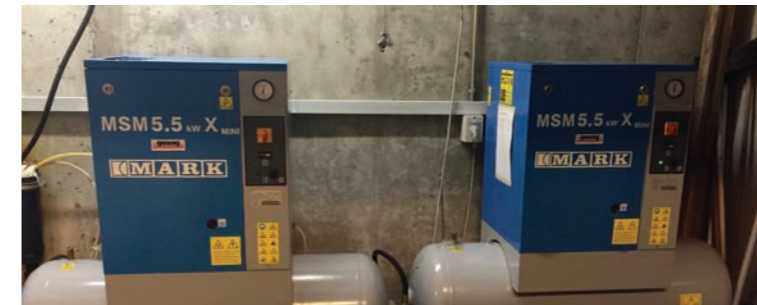
Zwei Schraubenkompressoren à je 5.5 KW
