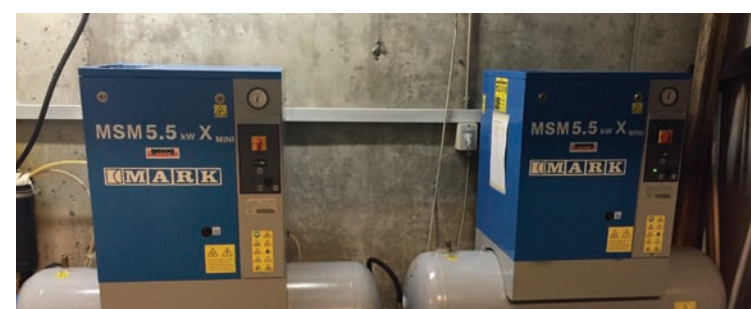
Zwei Schraubenkompressoren à je 5.5 KW
