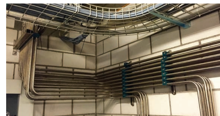
Ein paar hundert Meter Edelstahlleitungen
