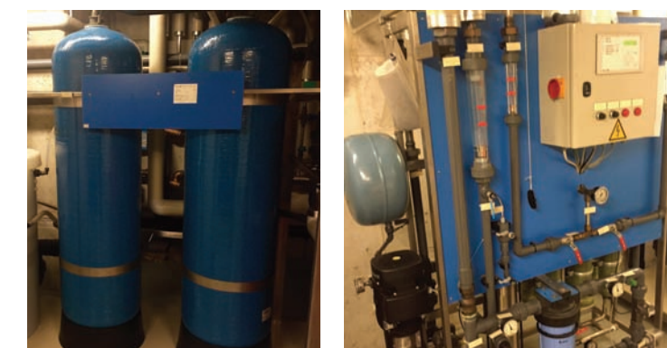
Wasserenthärtungsanlage und Osmosefilter
